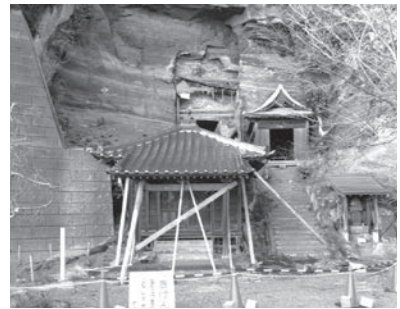
崩落箇所 那古寺 大黒堂付近
