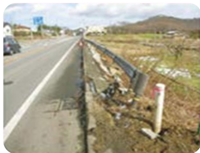
ガードレール・ 標識等の損傷
