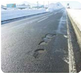
路面の穴ぼこ・段差
