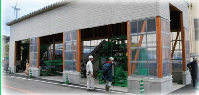
清掃センター内に整備されたマテリアルリサイクル設備
