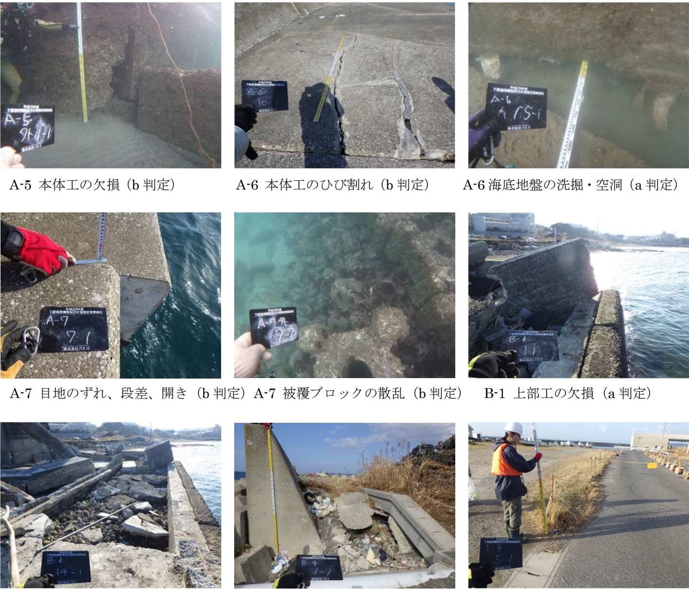
A-5 本体工の欠損 (b 判定) A-6 本体工のひび割れ (b 判定) A-6 海底地盤の洗掘・空洞 (a 判定) A-7 目地のずれ、段差、開き (b 判定) A-7 被覆ブロックの散乱 (b 判定) B-1 上部工の欠損 (a 判定) B-1 背後地の陥没 (a 判定) B-4 護岸背後の陥没、土砂流出 (a 判定) I-3 排水施設の堆積 (b 判定)
