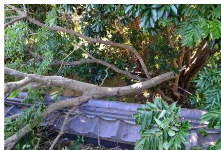
本館収蔵庫棟瓦の被害状況
