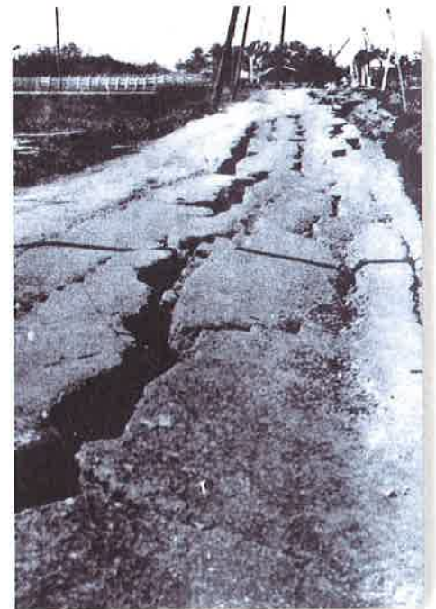
北条の地割れ
