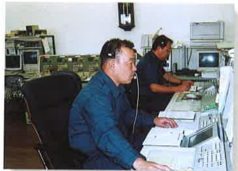
消防本部の指令室
