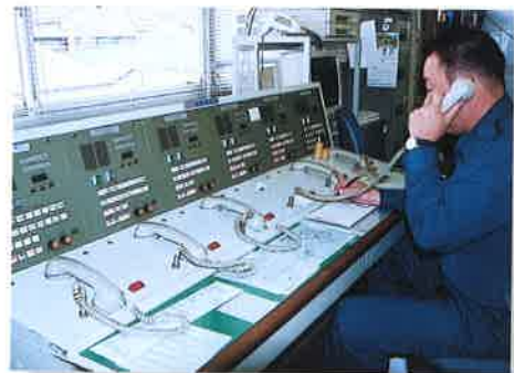
消防本部の指令室
