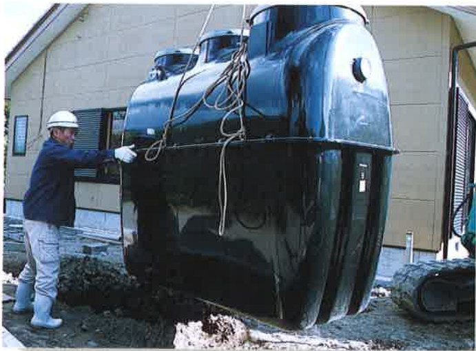
各家庭に設置される合併処理浄化槽
