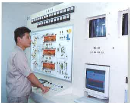
コンピューターで監視します
