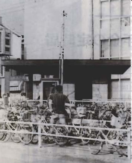
夏の観光シーズンを前に急ピッチで進む案内所の建設
