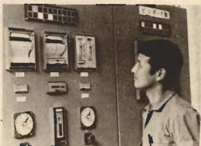
▶機械化された操作室
