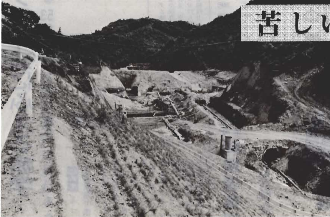
↑昭和52年度完成をめざし工事が急ピッチで進められている作名ダム。総貯水量は63万トン
