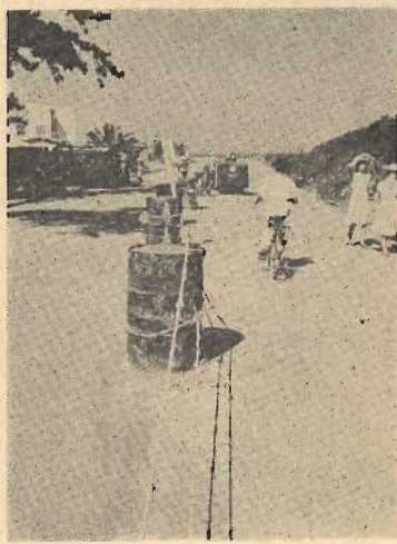
道路舗装工事 市道八幡海岸線 四月から着工していた市道八幡海岸線（八幡神社）
