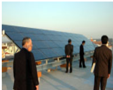
▲屋上に設置された太陽光パネル
